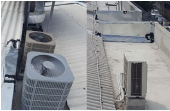
■ Movimiento de dos centrales y un condensador de aire acondicionado para impermeabilizar losa del área ingreso a salas múltiples.
